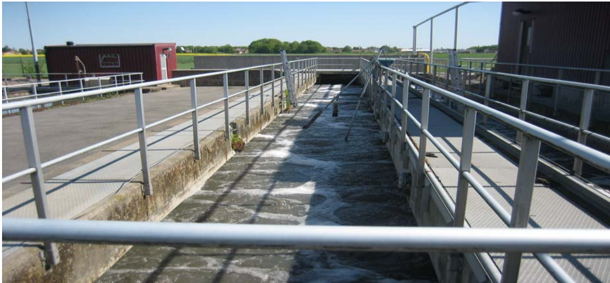
Fig 3 Luftningsbassäng, Vara avloppsreningsverk
